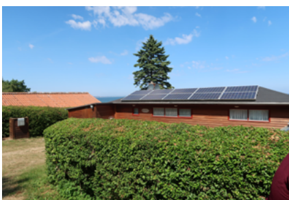
Figur 4: Eksempel på solpaneler liggende fladt på tagfladen
