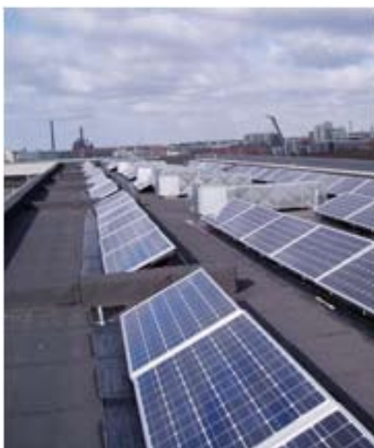
Eksempel på solceller lagt på fladt tag
